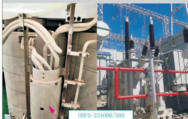
开关 WDB 1 I 3150/252-5*5 (212) BX，安装于线圈三角区
